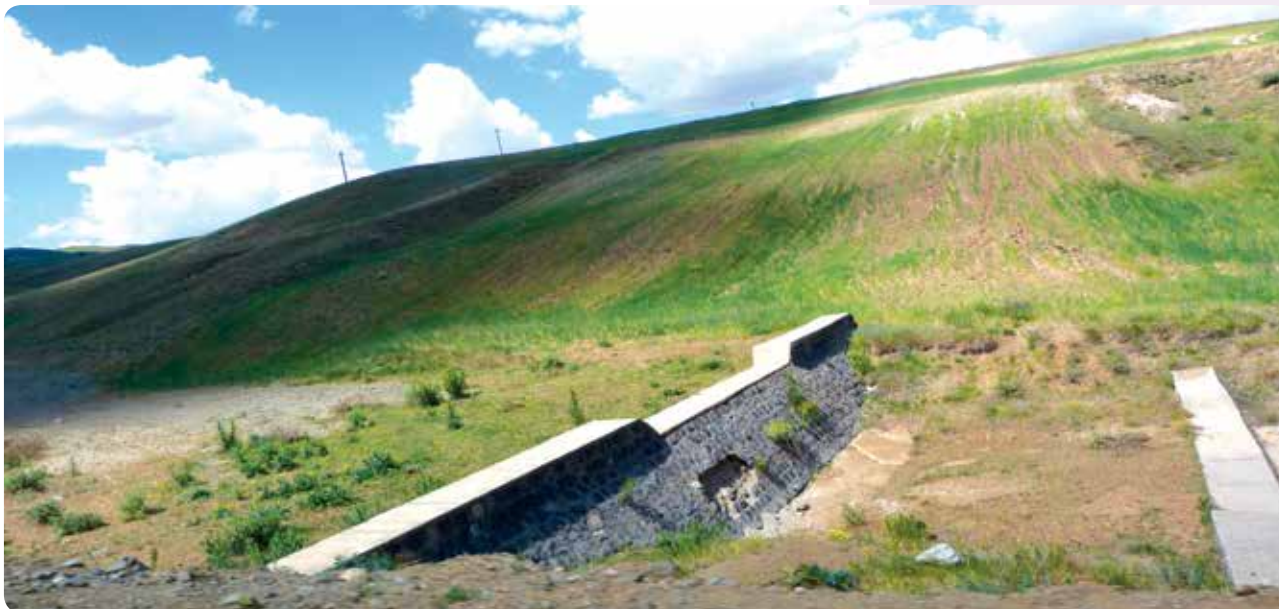
شکل ۱۲- تبدیل مراتع به دیم‌کاری غلات (اردیبهشت ماه ۱۳۹۵، سلماس، آذربایجان غربی) همانگونه که در پایین تصویر مشاهده می‌شود، مقدار هدررفت خاک سطحی، به‌واسطه تبدیل مراتع منطقه به دیم‌کاری غلات، به اندازه‌ای است که بعد از گذشت دو سال از احداث سازه سنگی ملاتی، خاک فرسایش یافته حجم مخزن پشت سازه را پر کرده است.
